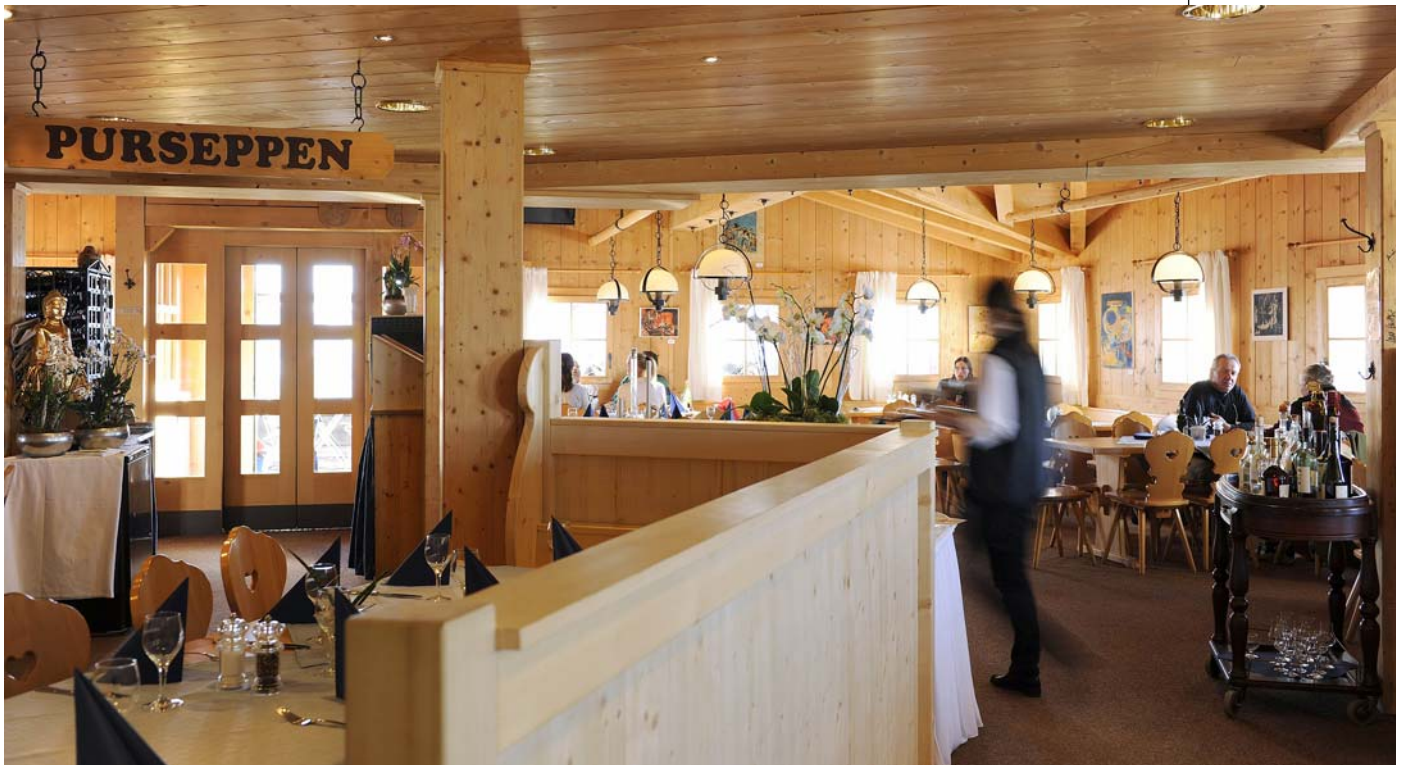
Dali-Leuchten sorgen für angenehmes Licht im Restaurant Scalottas. Die Steuerung passt die Lichtstärke dem Tageslicht an.
