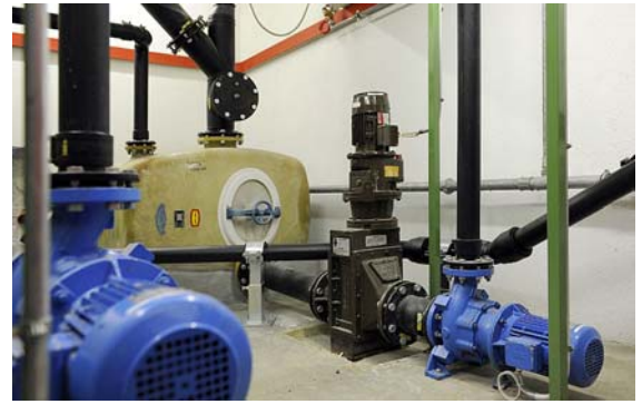
Das Abwassermanagement gehört zum Gewerk Wasserversorgung. Ist der Muncher (Zerkleinerer) am Standort Scalottas blockiert, erfasst der Wago-Knoten die Störung als Alarm und indiziert automatisch eine SMS.
