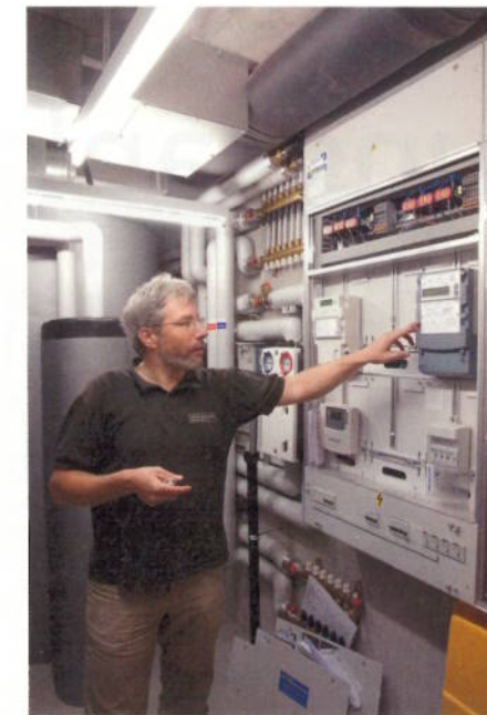
Andreas Beer vergleicht im Keller die Zählerwerte des Stromverbrauchs und der PV-Produktion.
