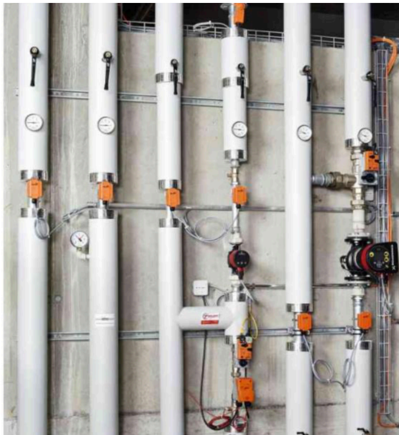
Die Sensoren von Belimo lassen sich durch ihr werkzeugfreies Gehäusekonzept leicht und schnell installieren, hier in der Wärmepumpen-Anlage der Motta Hütte.
