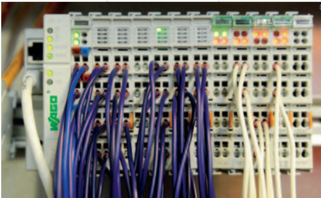
KNX-Controller automatisieren dezentral die verschiedenen Gewerke und kommunizieren mit dem Leitsystem.
