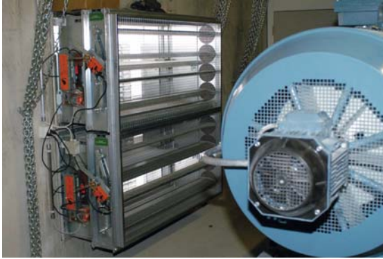
Lüftungsklappe Wärmerückgewinnungsanlage Antrieb Bergbahn Scharmoir-Canols (Abwärme 80 kW)
