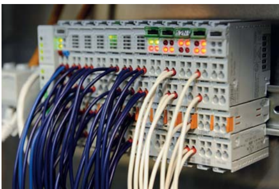
SPS-Steuerung für die Ansteuerung von Licht, Einzelraumregelungen, Lüftungen, Heizungen in einem Restaurant
