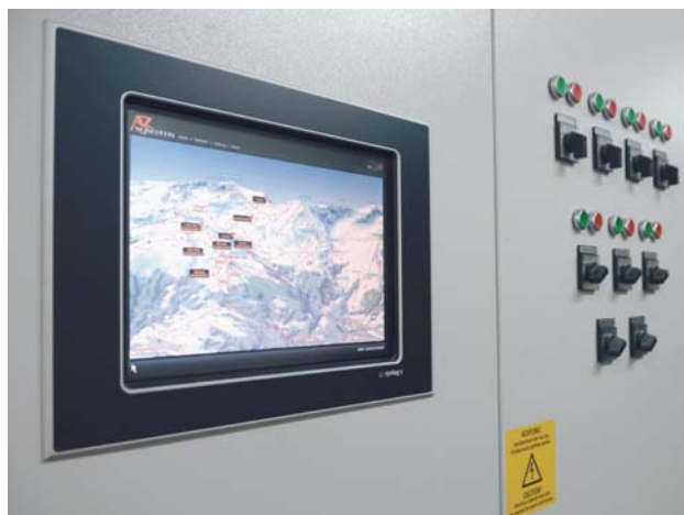
Mit dem Syslogic Panel wird die Wasserzufuhr des Gletscherrestaurants Vorab gesteuert.
